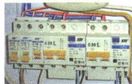
Рис. 91. Современный квартирный щиток с предохранителями
